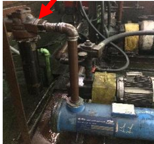
Fig. 4 – Unidade Hidráulica de Filtragem – Filtro inadequado
