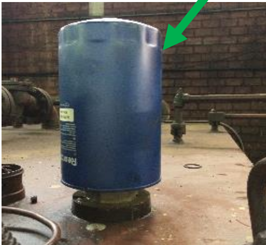
Fig. 5 – Reservatório - com respiro adequado.
