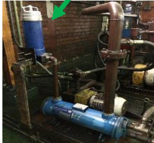
Fig. 6 – Unidade de Recirculação e Filtragem – Filtro Adequado
