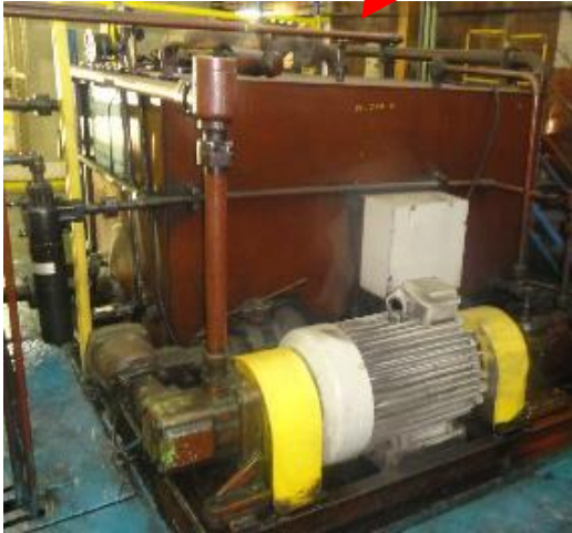
Fig. 3 – Reservatório sem respiro
