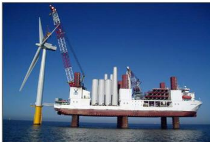
Figura 11: Instalação Real de uma Grande Unidade Aerogeradora Offshore
