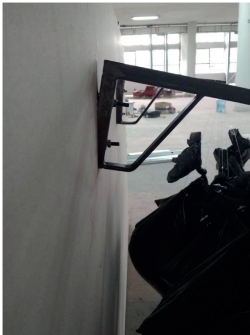
Figura 1 – Ruptura da placa de drywall na extremidade inferior da mão francesa
