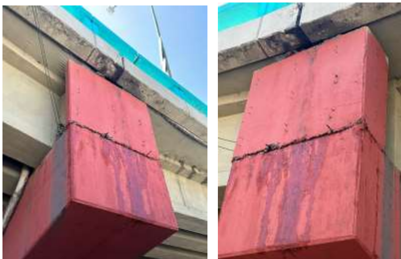
Figura 10 e 11 – Rachaduras em peça de apoio
