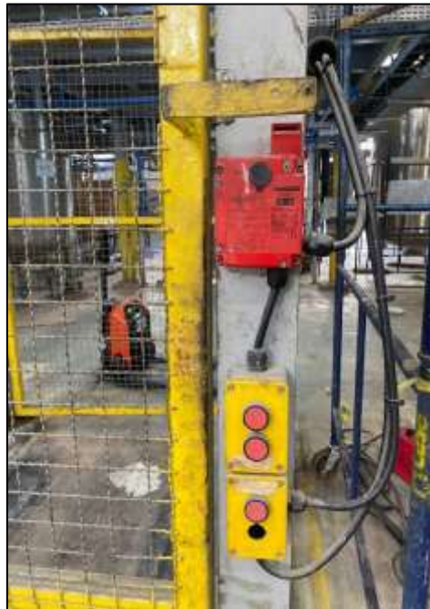
Figura 3 – Sensor de movimento e botoeira de emergência parte frontal
