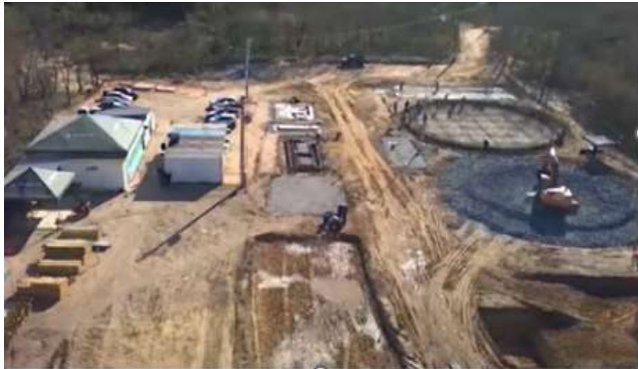
Figura 2: Demonstração do início da construção de uma estação de tratamento de esgoto
