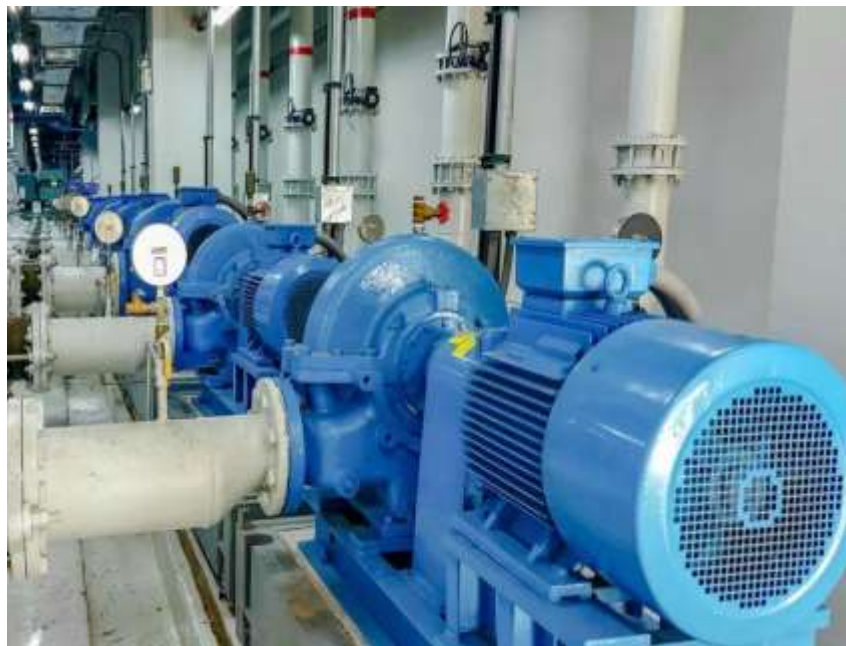
Figura 1: Conjunto motor-bomba hidráulica em funcionamento
