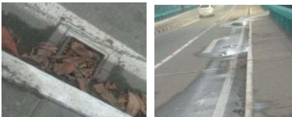
Figuras 08 e 09 – Ralos de escoamento entupidos
